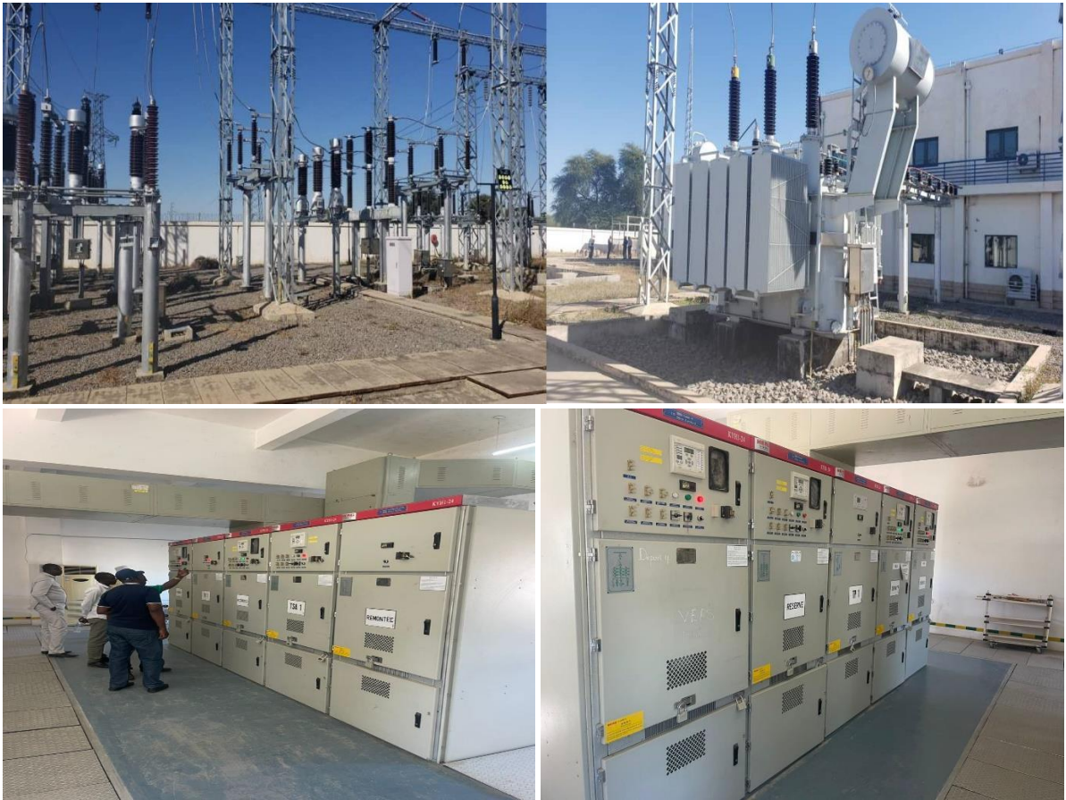
Figure 2 : Travée 90Kv - Transformateur 90/15kv de 25MVA - Des cellules disjoncteurs départs
